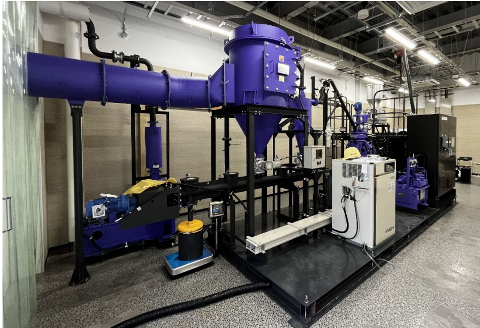
U B E マシナリーが山形大学有機材料システム事業創出センター内に納入した実証機
