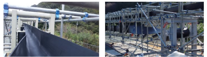
図-11 フリーラインコンベヤ写真
