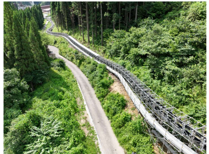
図-12 フリーラインコンベヤ写真
