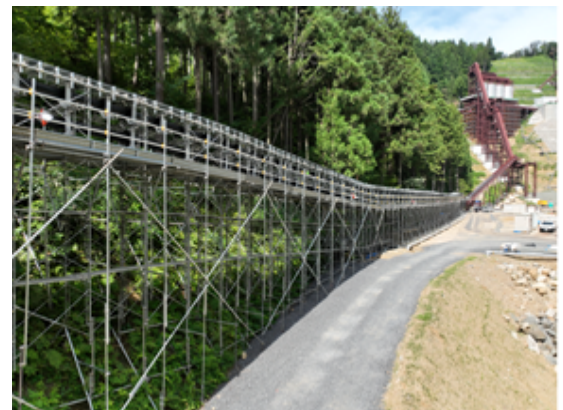
図-13 フリーラインコンベヤ写真
