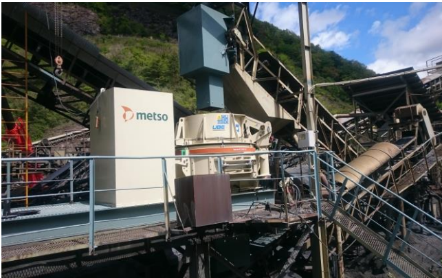
図8 BM7150SE 納入設置写真
