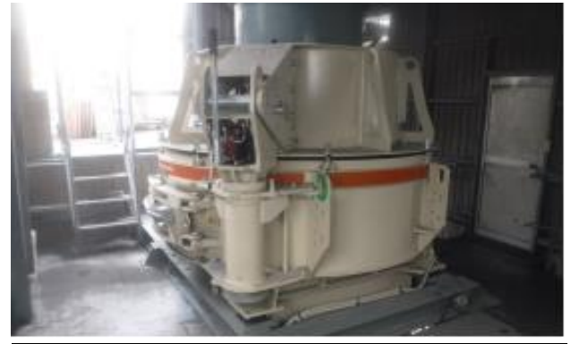
図9 BM7150SE 納入設置写真
