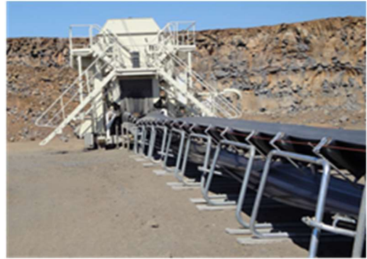
写真-⑦ 仮設ベルトコンベヤ写真
