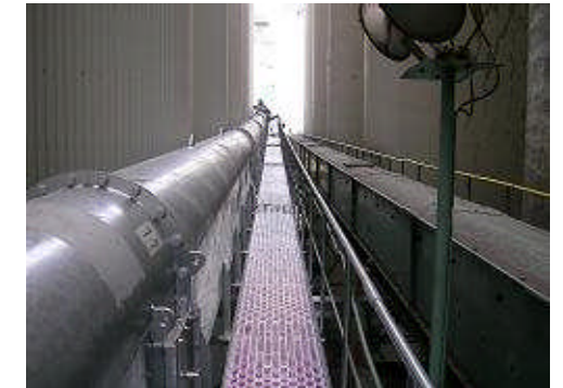
写真4: 例③全景(右側がチェンコンベヤ)
